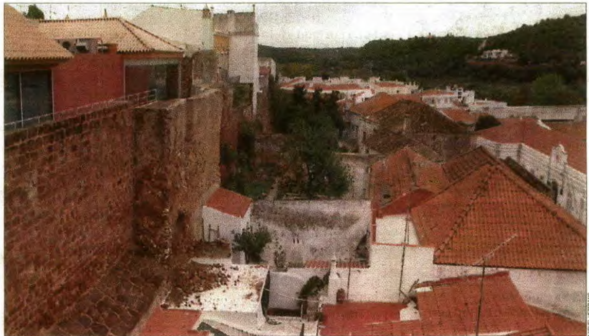
Uma derrocada da muralha já tinha ocorrido em 2012 (na foto), este ano registou-se outra próxima da câmara
